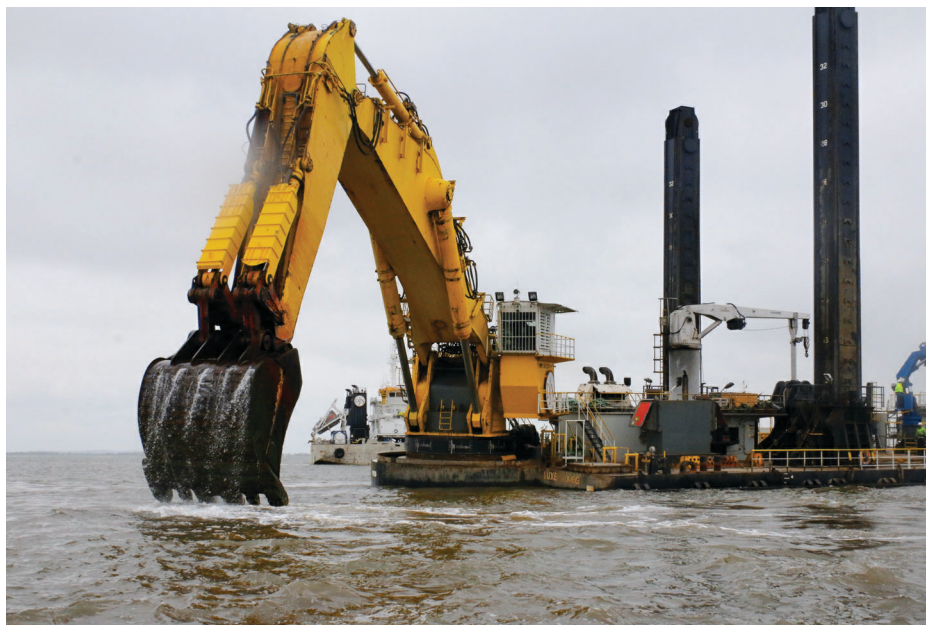
Im Hamburger Hafen und der Elbe wird fortlaufend gebaggert, um gegen das Schlickproblem anzukämpfen.
