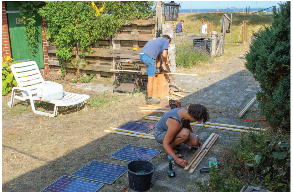
Vor dem Wohnhaus wird ein Gerüst für die Erweiterung der Photovoltaikanlage gebaut. Fotos: Stella Klasan
