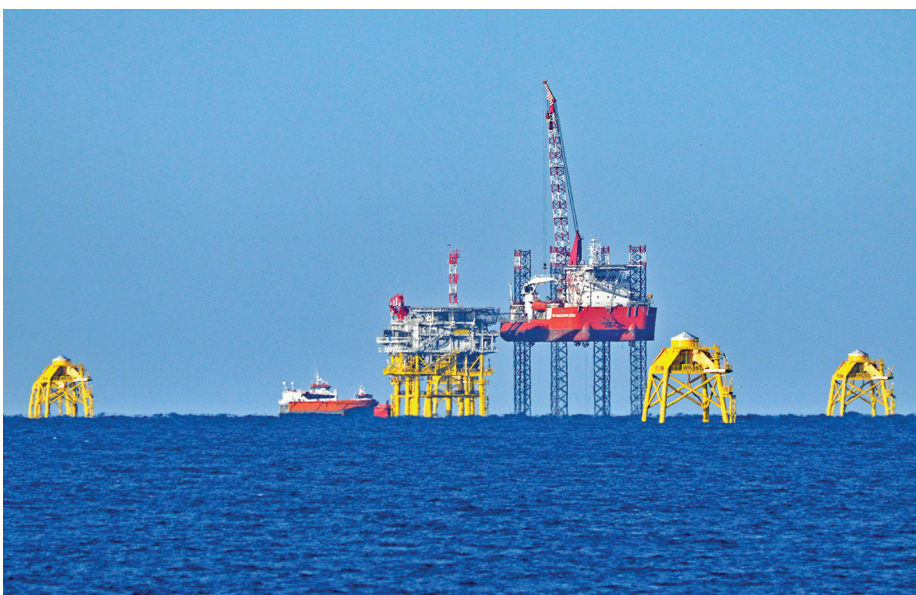
Immer mehr Offshore-Windparks werden in Nord- und Ostsee gebaut, wie diese Großanlage im Adlergrund vor Mecklenburg-Vorpommerns Ostküste. Alle Fotos: Harro H. Müller
